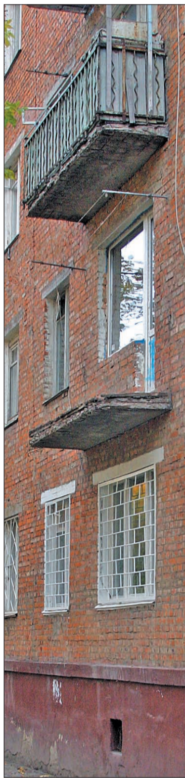
10 октября 2008 г., Тула, улица Ползунова, 7/13. Перила балкона квартиры №26 не выдержали веса строителей?
