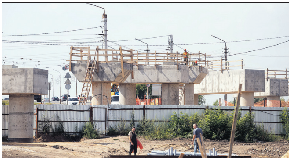
Работа на объекте идет в две смены по 12 часов. Трудятся сразу девять подрядчиков, около 250 человек.
