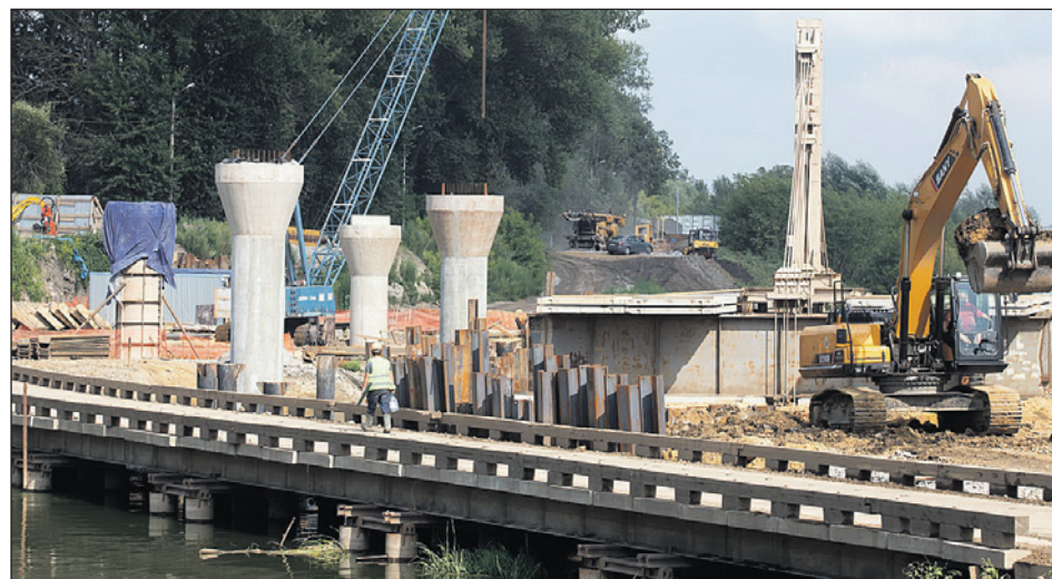
На сегодняшний момент строительная готовность – 28%. Из 43 опор 21 уже сооружена. Залиты все 200 свай.
