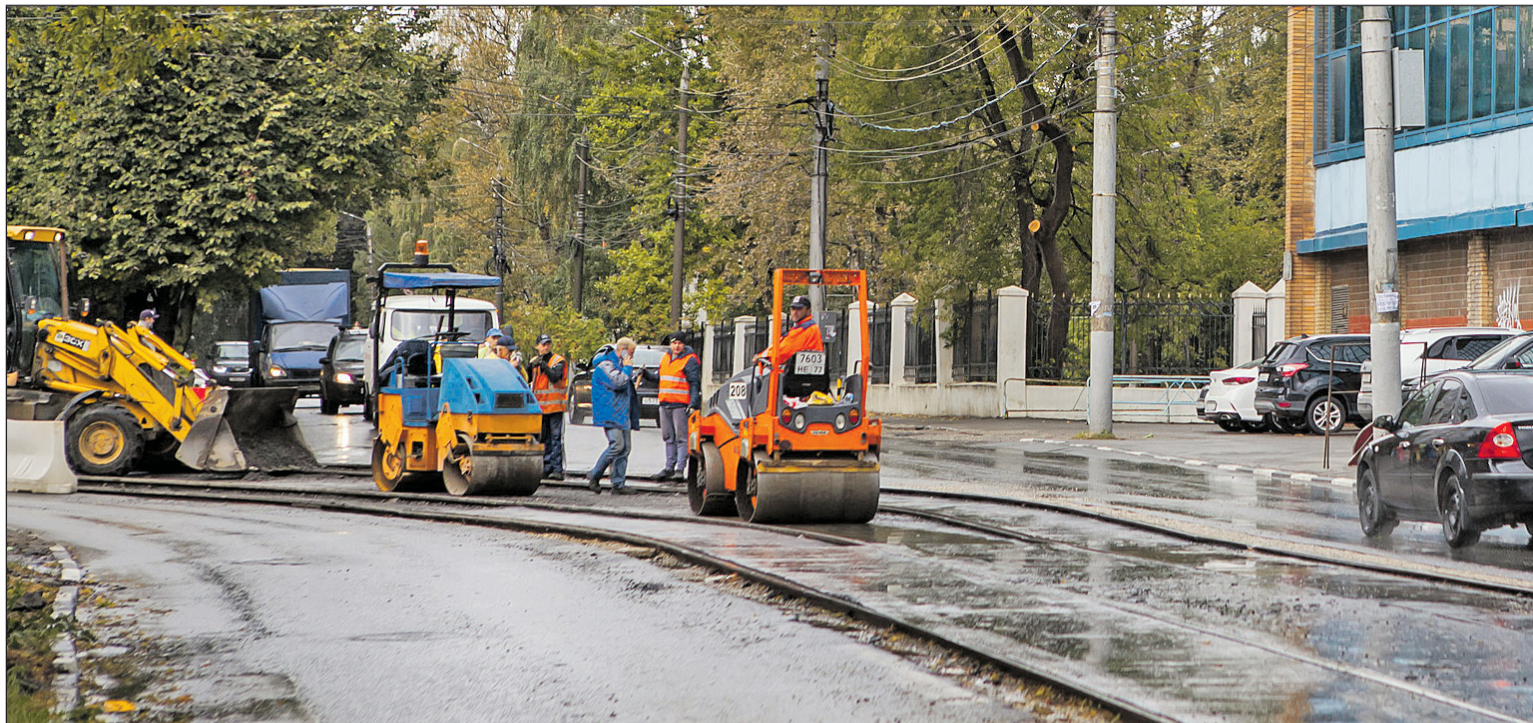
27 сентября, Тула, улица Николая Руднева. Ремонт дорожного полотна здесь стартовал в начале августа. На фото рабочие укладывают асфальт на межрельсовое пространство.
