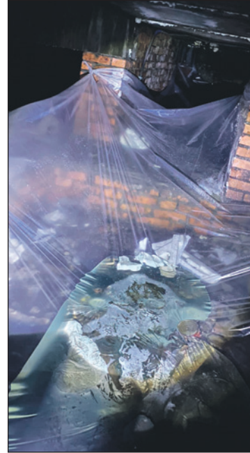
Вместо ремонта крыши над квартирой Татьяны Соболев оказалась натянута пленка.
