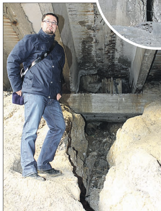
18 ноября 2011 г. Демидовский мост. Повсюду гнилая арматура, трещины и осколки бетона.
