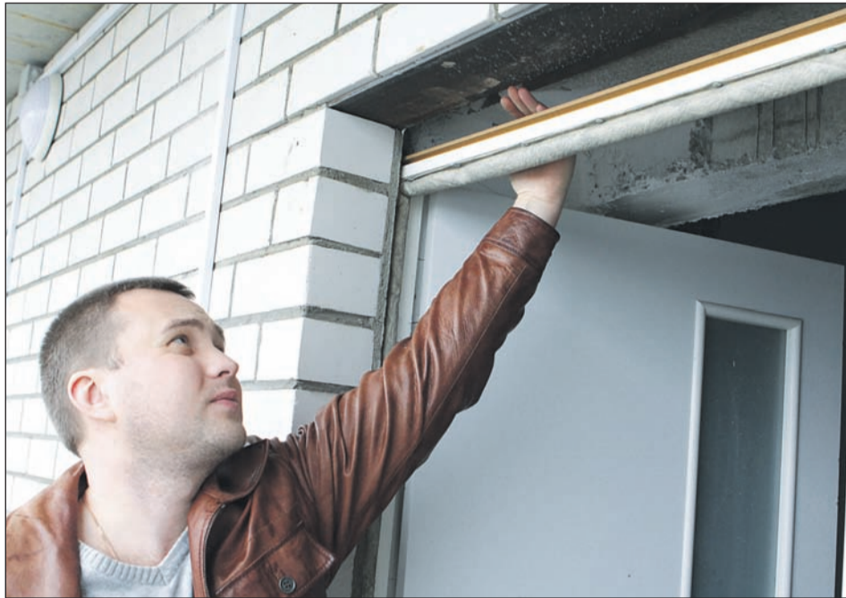
Андрей Чирков: «Подвездные двери, видимо, не подошли по размеру и в проем не вписались. Строители прилепили утеплитель, а щель над ним оставили».
