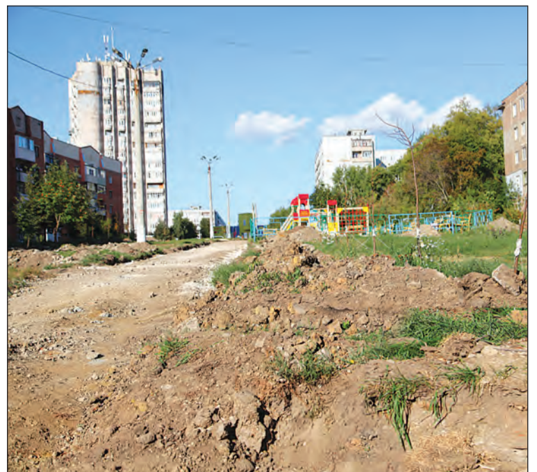
31 августа 2015 г. Тула, 2-й проезд Металлургов. Молоденькие липы погибают под тяжестью отваленого грунта и старого асфальта.
