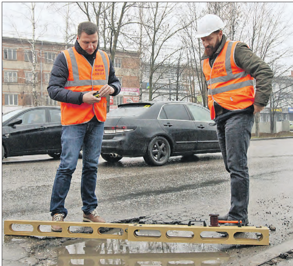
Новомосковское шоссе. Вот это ямища! Полтора метра шириной. Почему подрядчик не ремонтирует её по гарантии?
