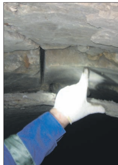
Коллектор весь в трещинах, причем в таких, которые уже не заделать!
