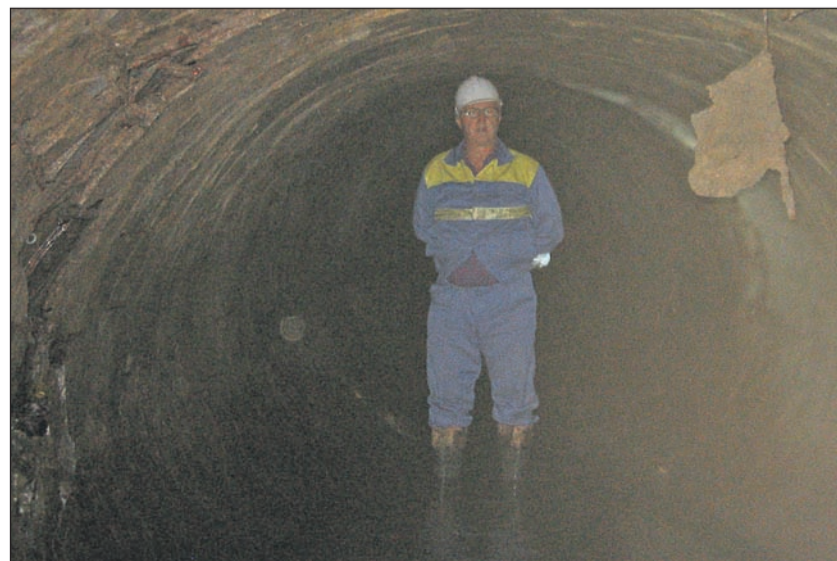
Аварийную тульскую ливневку никто не обслуживал около 80 лет! Изнутри труба уже стала эллипсом, а значит, до обвала недалеко.
