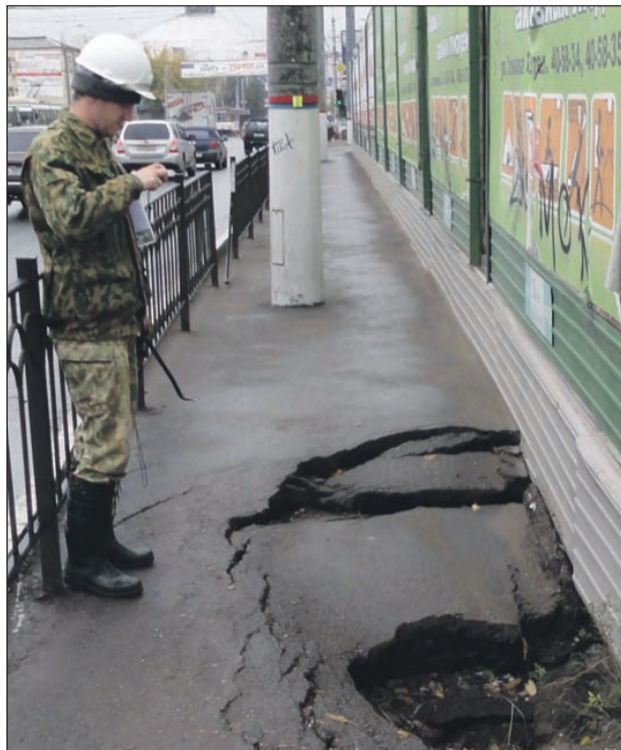
Тула, ул. Советская неподалеку от здания областного УГИБДД. Недавно здесь просела часть асфальта прямо на пешеходной дорожке.
