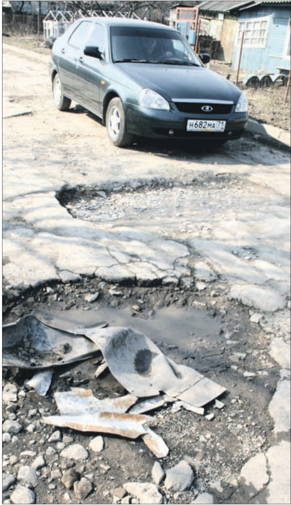
28 апреля 2009 года. Тула, Мясоново, ул. Краснослободская. На эту ямищу туляки жалуются давно! А она все еще «жива»...
