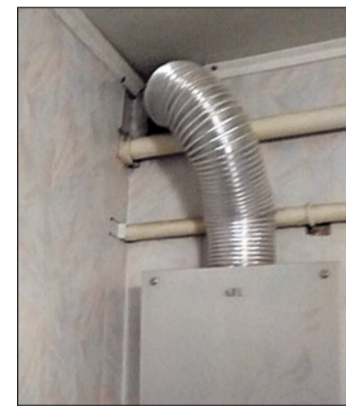
Неплотное соединение дымоотвода от газовой колонки с дымоходом.
