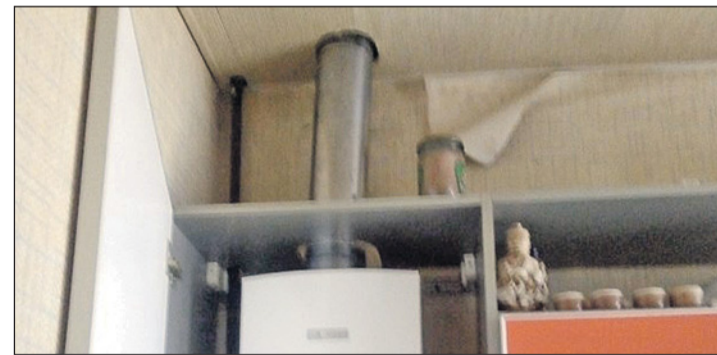
Нет доступа для проверки места соединения дымоотвода с дымоходом.
