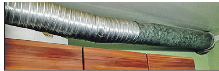
Наиболее предпочтительный материал для изготовления дымоотвода – нержавеющая сталь. Недопустима эксплуатация дымоотвода из разных материалов.
