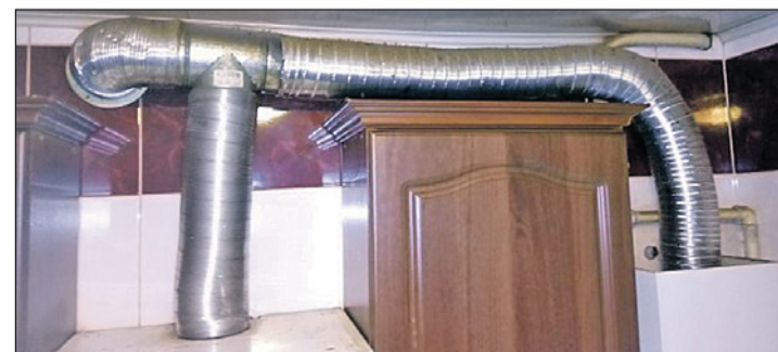
Подключение вытяжного зонта к системе дымоудаления. Данная конструкция категорически запрещена к эксплуатации.
