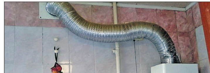
Нет вертикального участка, провис горизонтальный участок дымоотвода от газовой колонки, нарушена целостность гофрированной трубы. Она небезопасна в использовании. Во время работы газового прибора угарный газ может выйти в помещение.
