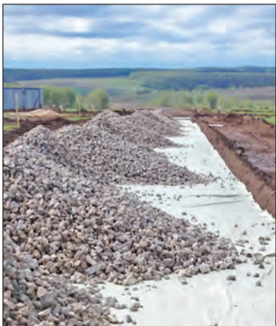
В Скворцово уже прокладывают дорожное полотно. От Тулы всего 12 километров по Венёвскому шоссе!
