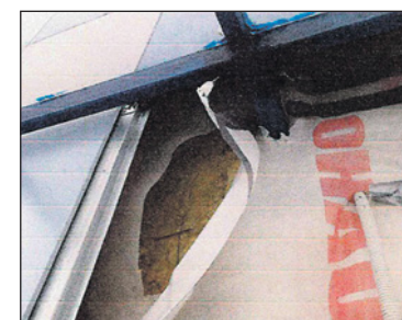
Утеплитель не изолирован.
