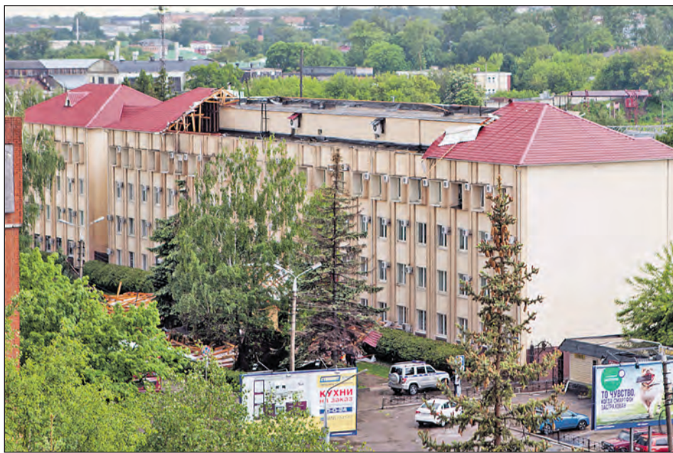
Ул. Путейская, 12. В результате сильного порыва ветра со здания Тульского управления РЖД сорвало часть крыши.
