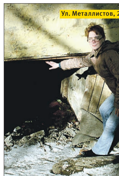
Из-за сырости от затопленного подвала жильцы болеют астмой.
