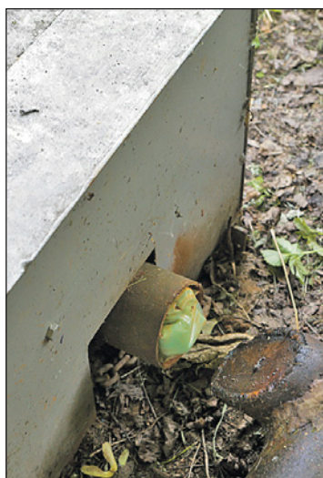
«Монтажник» отрезал деревне воду, заварив трубу.
