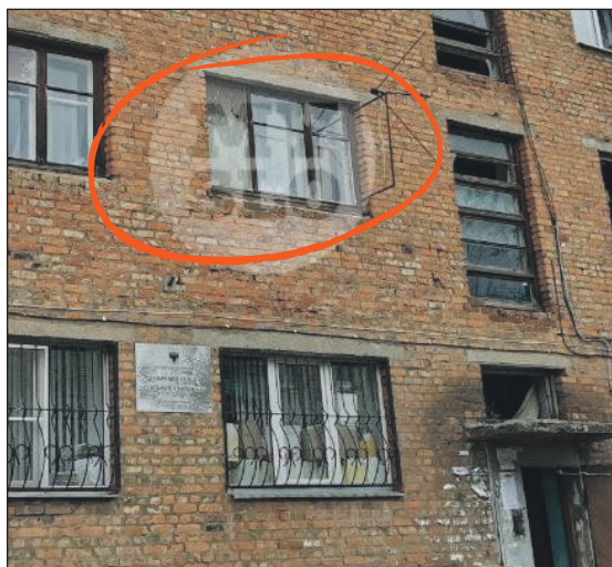
Предварительная причина пожара – техническая неисправность электрооборудования.
