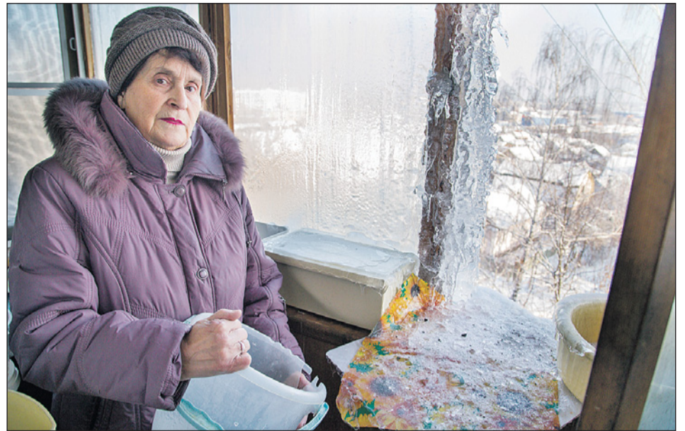
Балкон Аллы Евгеньевны Рязанцевой из-за наледи оказался разрушен. При первом потеплении его полностью затопило. Тула, ул. Волоховская, 8.
