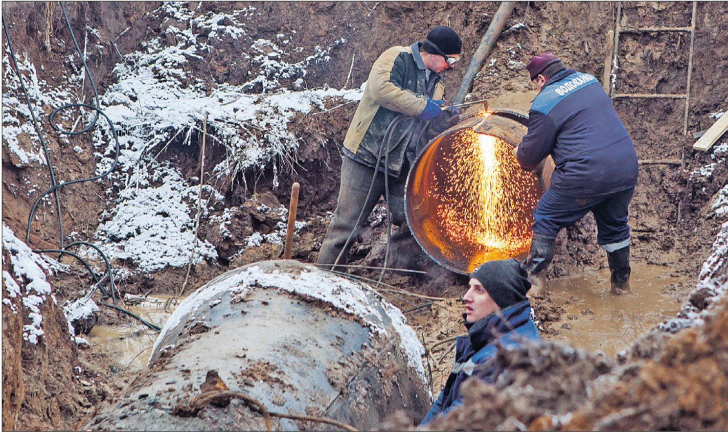
Стальные трубы водовода были проложены в 70-е годы. Срок службы таких труб 20 лет. Именно это, по заключению администрации Тулы, и является причиной повышенной аварийности.
