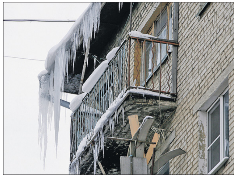
Тула, ул. Гастелло, 88. Опасная наледь размером с целый этаж.
