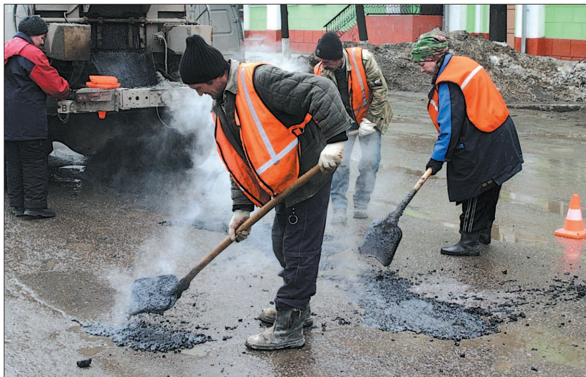
«У нас кладут асфальт местами и немного, чтоб всякий оккупант на подступах застрял...» (Тула, ул. Оборонная, 12 марта 2007 года).
