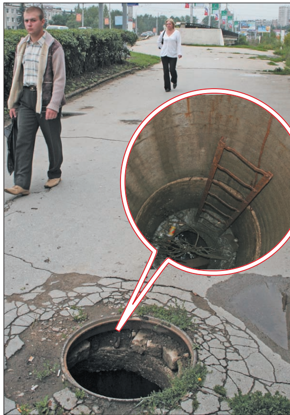
Колодец почти 5-метровой глубины простоял открытым неделю! Чудо, что за все это время в него никто не упал. Ул. Октябрьская, 3 августа 2007 г.
