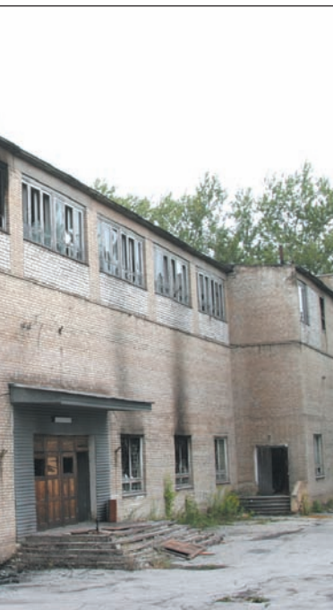
После нескольких пожаров здание спорткомплекса на стадионе «Металлург» требует капитального ремонта.
