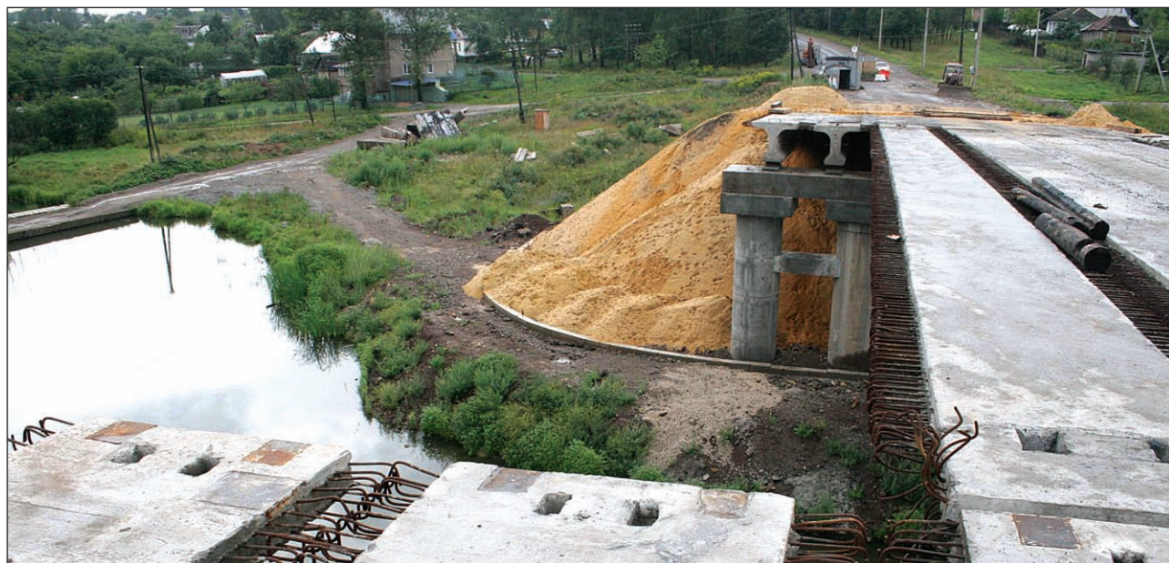
Косогорский мост. Власти обещают, что автомобильное движение здесь возобновится до конца года.
