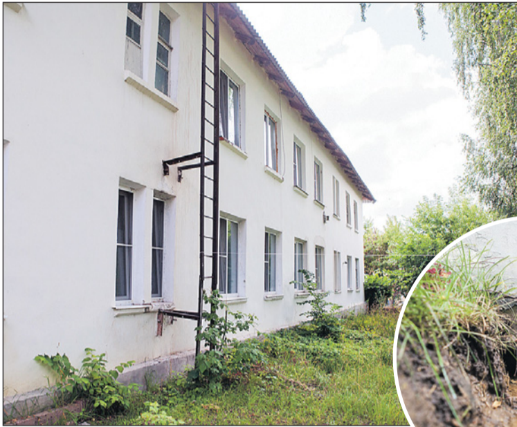
Из-под дома в Барсуках на ул. Советской, 9 текут ручьи. Из-за сырости в фундаменте появились трещины.
