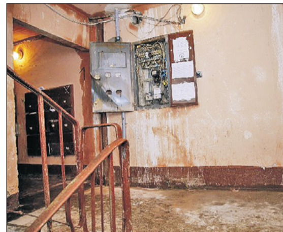
Вот так выглядит подъезд дома, у которого засорилась труба ливневки.
