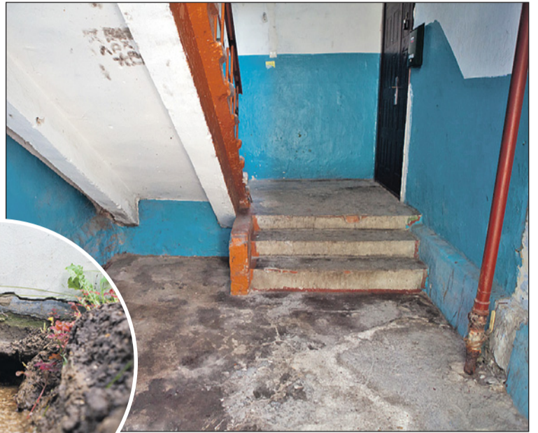
Стены и пол в подъездах полностью промокли. Жители опасаются, что здание не успеет просохнуть до зимы.
