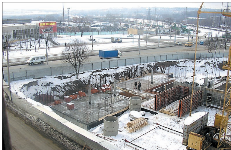
Февраль 2008 г. На стройплощадке будущего жилого комплекса полным ходом идут строительные работы.
