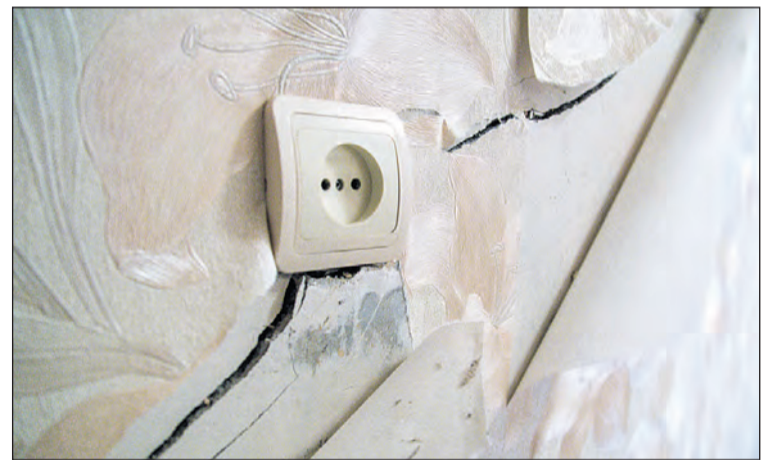
...из-за этого по ней пошли трещины, искривились полы.
