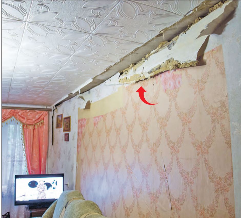
Тула, ул. Рязанская, 34, корп. 3. Вид из квартиры №35: стену будто кто-то вдавил!
