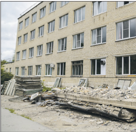
Больница в поселке Первомайский нуждается в ремонте.
