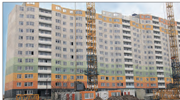
30 марта 2015 г. В первом доме «Новой Тулы» уже построено 15 этажей, во втором – 5. Закладывается третий корпус.
