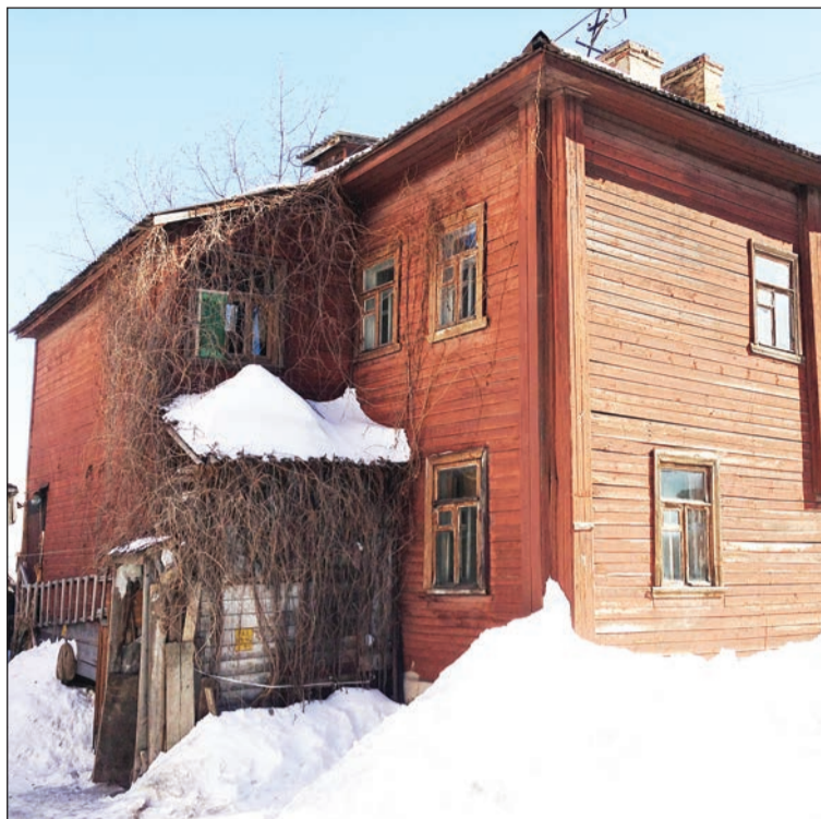
Тула, ул. Демонстрации, 16. Дом построен в 1917 г. 11 лет назад его признали ветхим, но три семьи до сих пор здесь живут!
