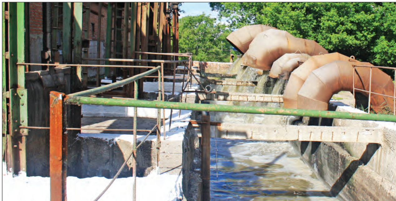
Июнь 2015 года. Тула, набережная Дрейера, 64-б. Место слива отходов со всех предприятий и домов города Тулы. Средний износ муниципальных сетей, сооружений водоотведения составляет 87,80 процента.
