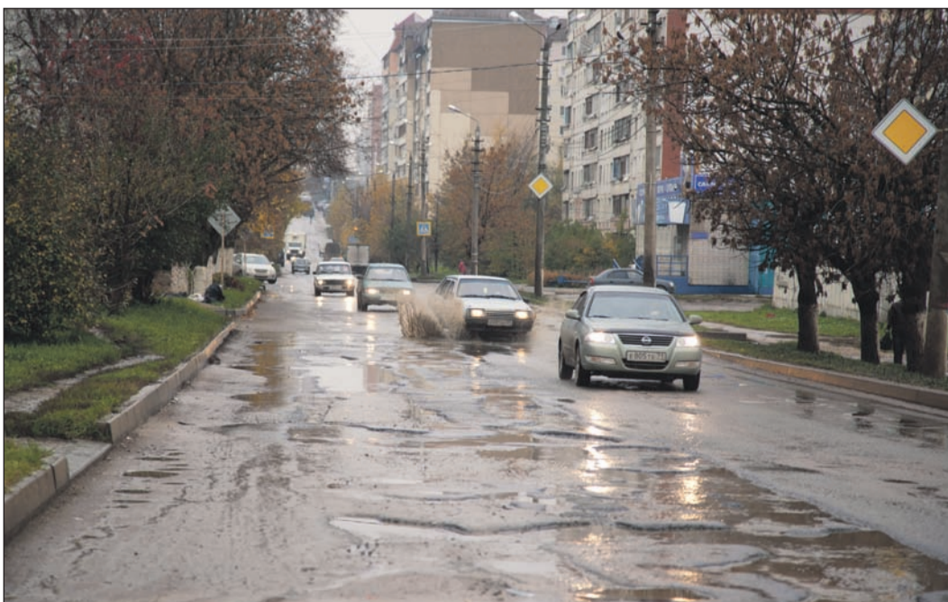
По улице Степанова до сих пор не проехать – яма на яме! (Улица не входила в план ремонта дорог).
