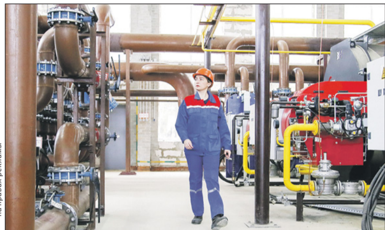
Котельная полностью автоматизирована, что позволяет постоянно контролировать параметры работы.
