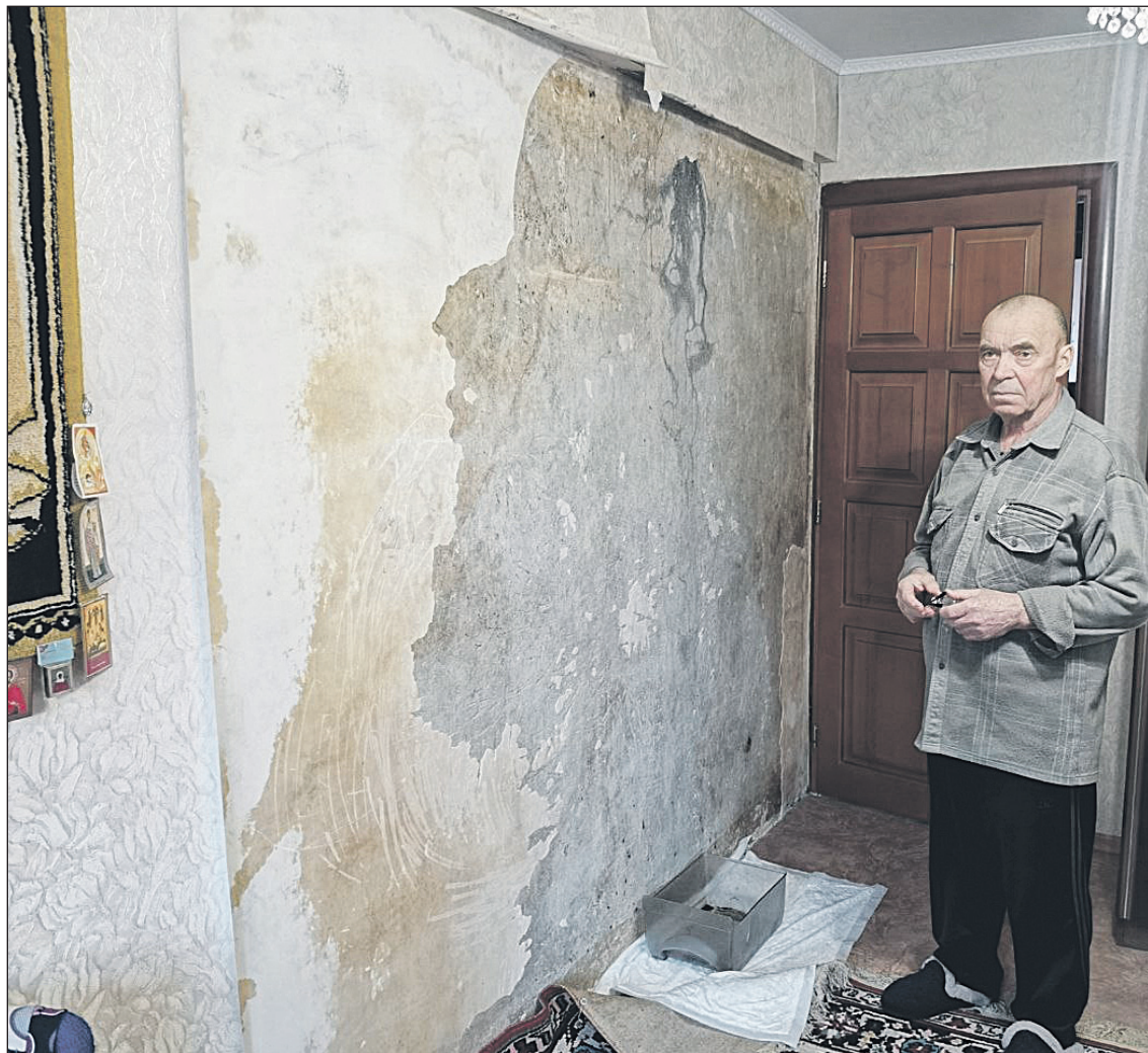
Виктор Горбатов больше года безрезультатно пишет обращения в связи с текущей крышей. Помогает это слабо: контейнер для капающей с потолка воды и бетонная плита – теперь обязательная часть интерьера.
