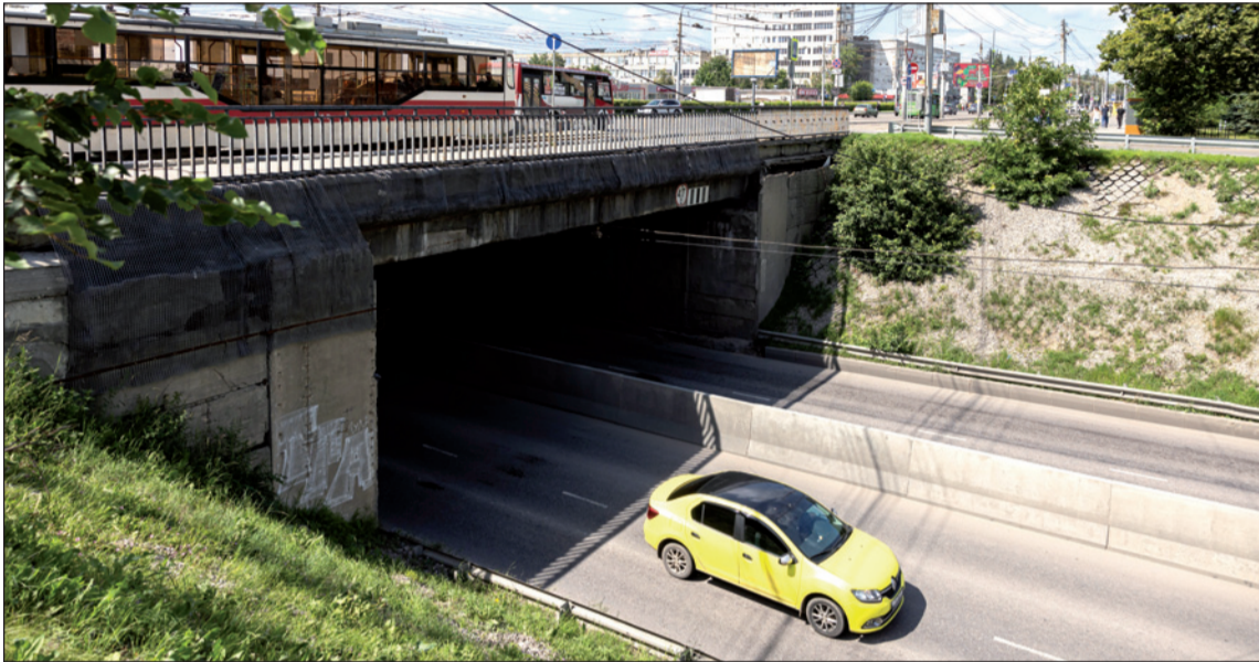
На время ремонта под мостом останется две полосы для движения. Падения камней на машины опасаться не стоит: здесь установят специальные устройства и заграждающие элементы.
