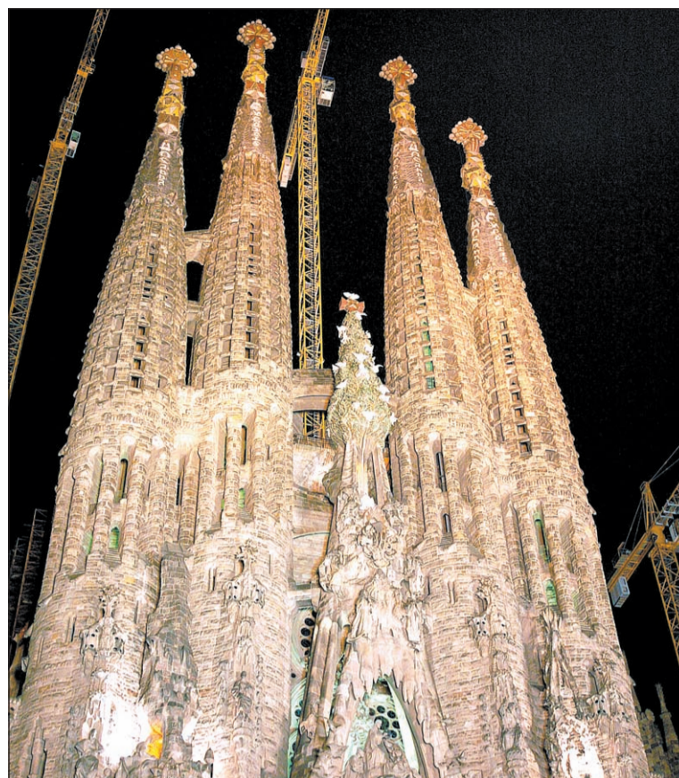
Визитная карточка Барселоны – собор «Святое семейство» – до сих пор находится в процессе строительства.
