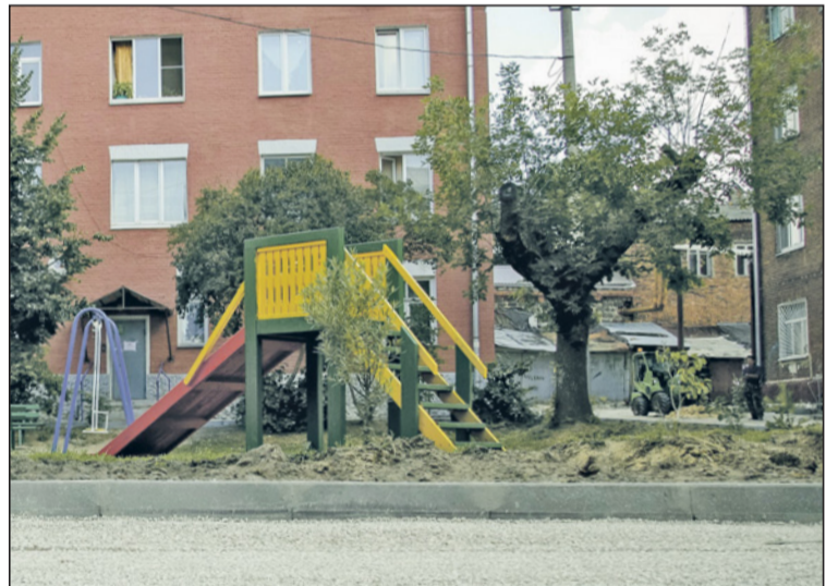
Во дворе дома №15 по ул. Луначарского уже подготовили территорию под укладку асфальта. Через неделю работы должны быть закончены.
