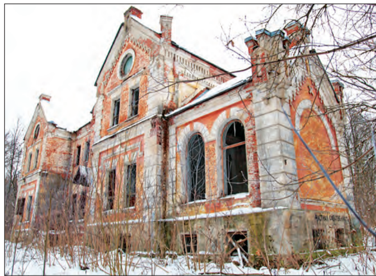
Дворец барона фон Мекка – «железнодорожного короля». После 1917 года в нём располагался детдом, а теперь здание разрушается.
