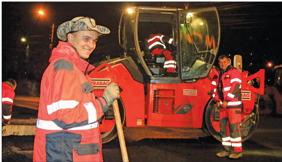
Работа по ремонту дорог закипит, как только сойдет снег. В планах администрации – отремонтировать 85 улиц.
