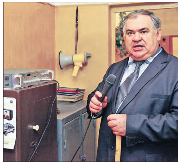
В убежище своя система оповещения: звук идёт на все этажи предприятия, так что о катастрофе оперативно узнают все!
