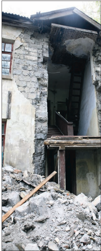
Донской, ул. Комсомольская, 15. За секунду в доме обвалился целый подъезд!
