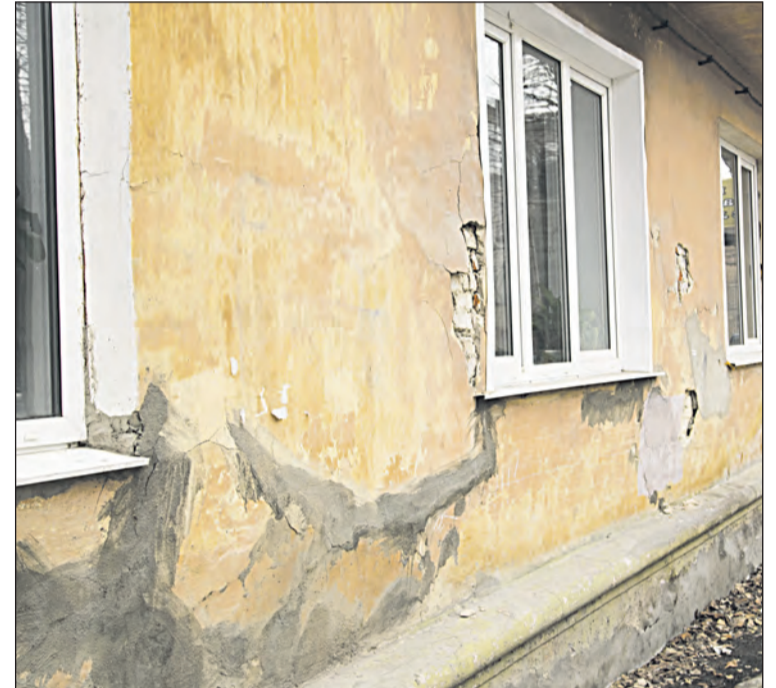
Стена дома деформирована. В квартире между ней и полом зияет почти полуметровая дыра.
