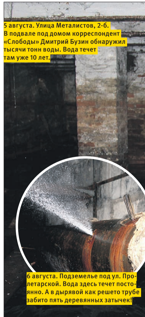
5 августа. Улица Металлистов, 2-б. В подвале под домом корреспондент «Слободы» Дмитрий Бузин обнаружил тысячи тонн воды. Вода течет там уже 10 лет. 6 августа. Подземелье под ул. Пролетарской. Вода здесь течет постоянно. А в дырявой как решето трубе забито пять деревянных затычек!
