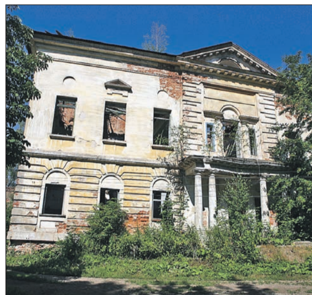
Так усадьба Языковых выглядит сейчас: остались только стены и балкон – тот самый, на котором помещики пили чай.
