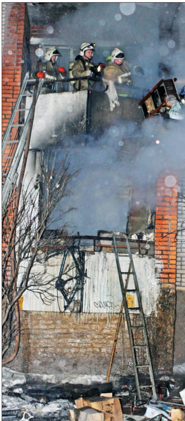
25 января, Тула, ул. Кауля, 20. Взрыв произошел в квартире на первом этаже. Пожар практически уничтожил две квартиры. Причина взрыва пока не установлена.
