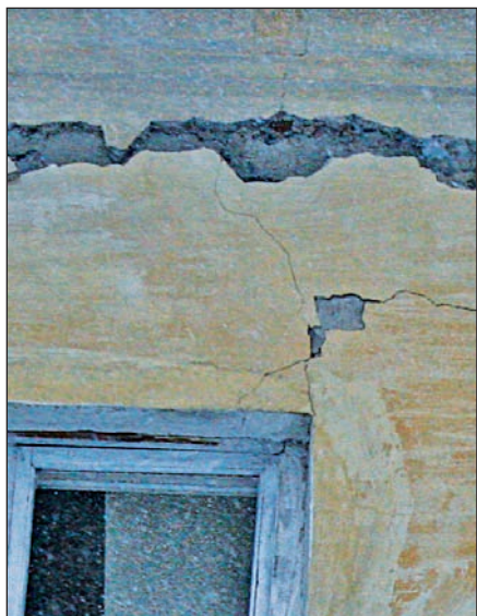
Стена старой «сталинки» дала внушительную трещину.
