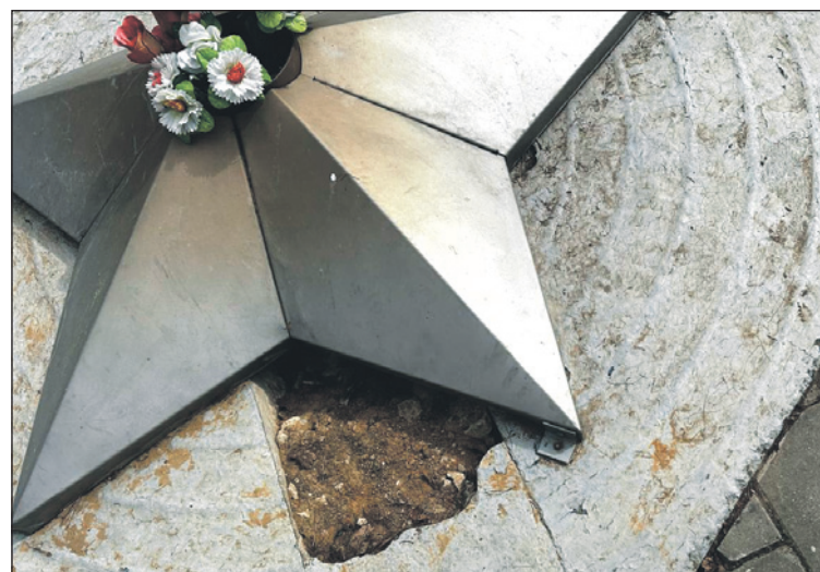
Бетон вокруг звезды не выдерживает капризов погоды. Поэтому он будет заменен на камень.
