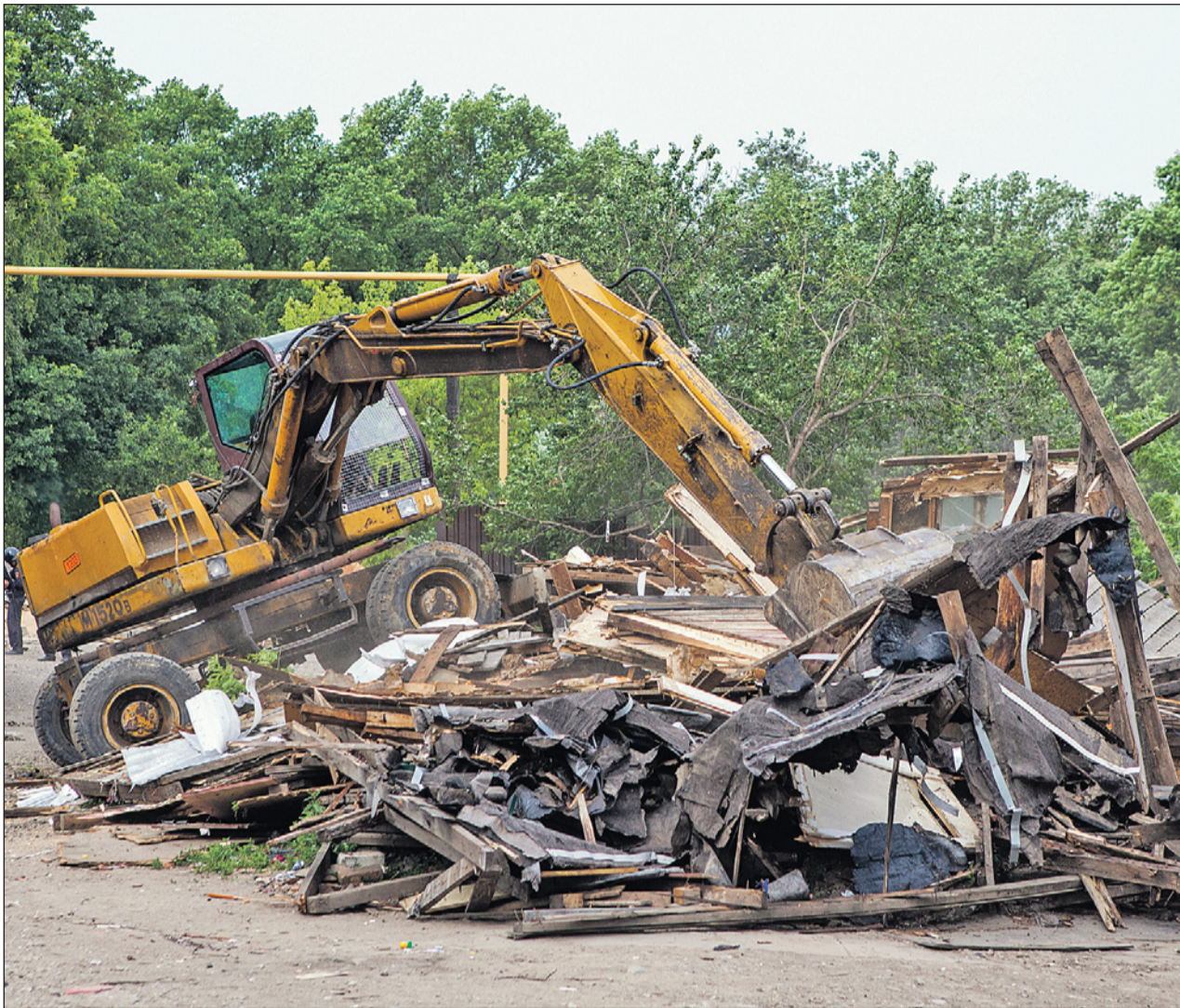
Хлипкие деревянные конструкции легко поддаются ковшу экскаватора: десять-пятнадцать минут, и на месте, где стоял дом, остается только гора строительного мусора.
