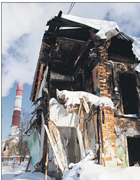
Барак на ул. Ушинского в Алексине выгорел практически полностью.
