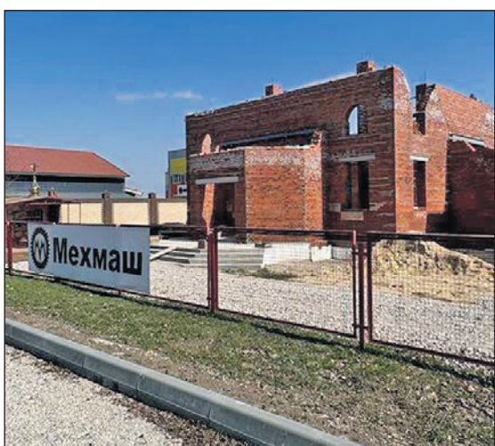
На территории идет строительство первого в регионе храма во имя Святителя Спиридона Тримифунтского.
