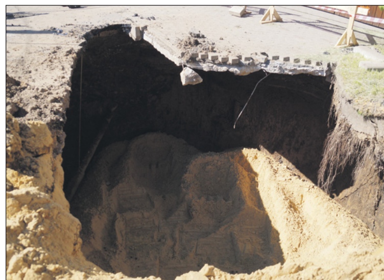
Яма огромного размера: центральная часть проезжей части просто повисла над ямой.
