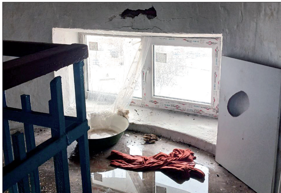
Крыша в трехэтажном доме на ул. Дм. Ульянова течет уже несколько дней.
