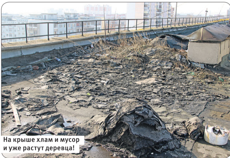
Из-за протечки кровли намочила проводка на верхних этажах.
