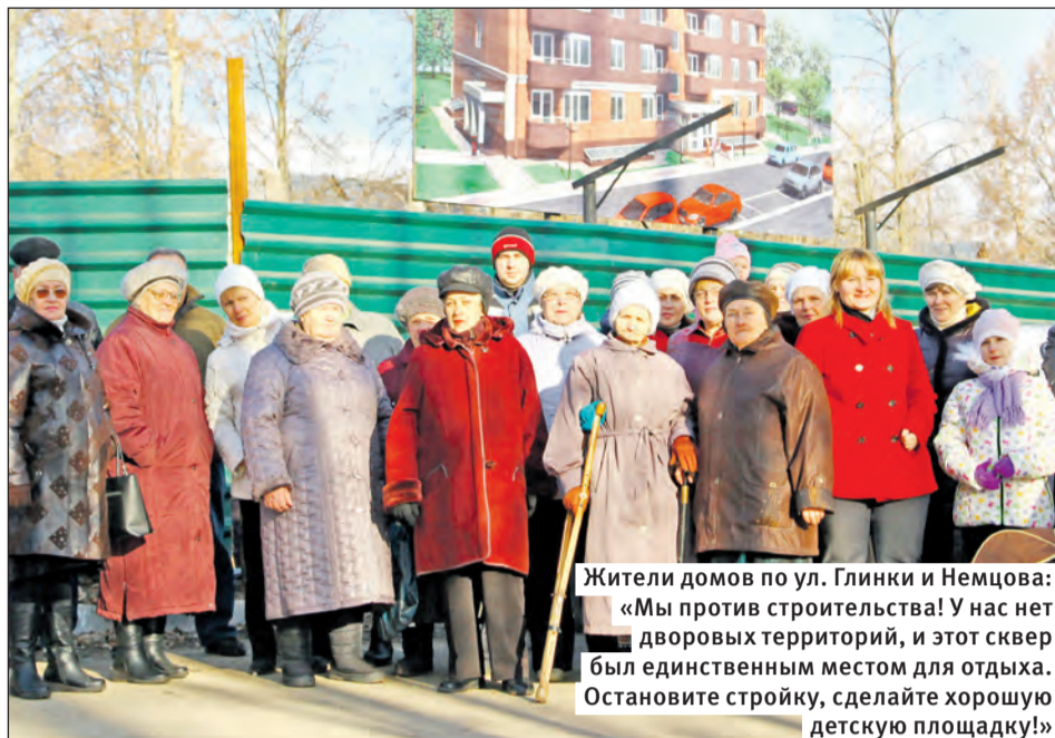
Чтобы покататься на качелях, дети теперь идут на стройплощадку, а когда она закрыта, пролезают под забором, – поиграть им больше просто негде.
