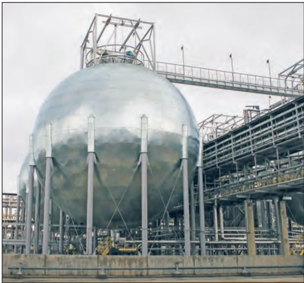
Склад жидкого аммиака на территории завода.
