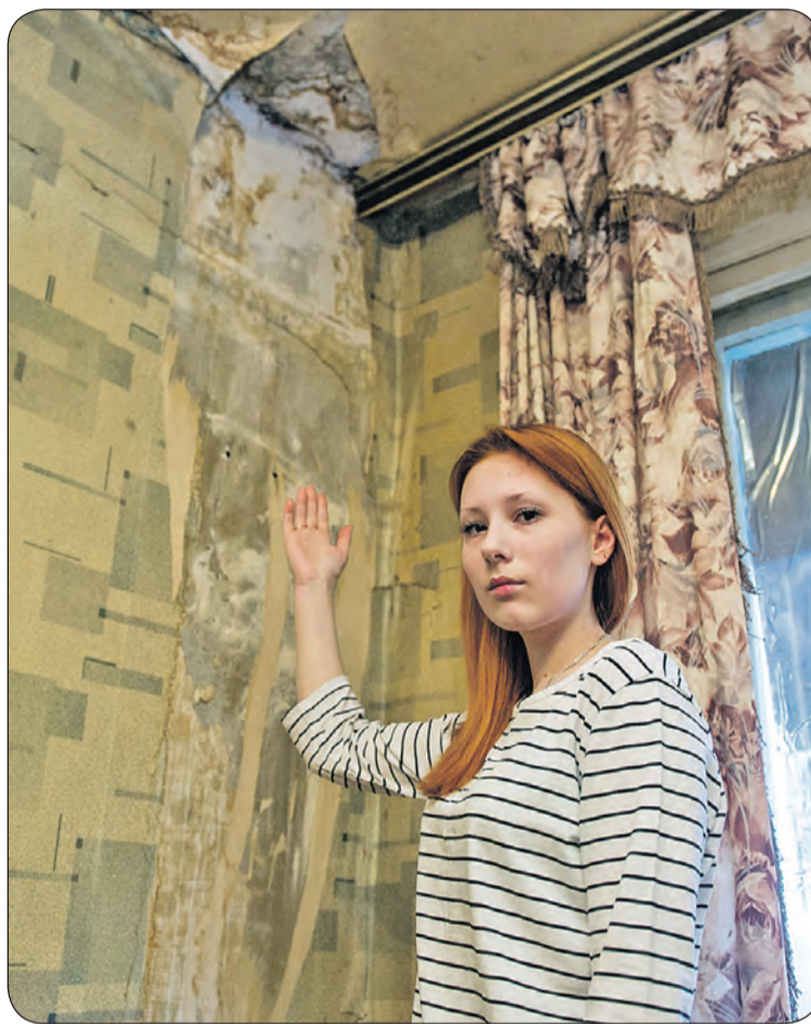
В квартире Анастасии Серёдкиной на улице Фучика, 22 из-за протекающей кровли безнадежно испорчен ремонт.
